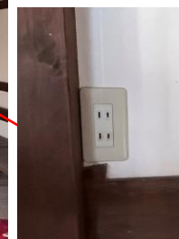
充電用 コンセント
