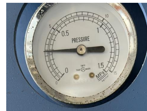
図 膨張タンク圧力メータ
