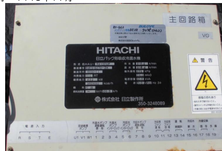
図 吸収式冷温水機 銘板
