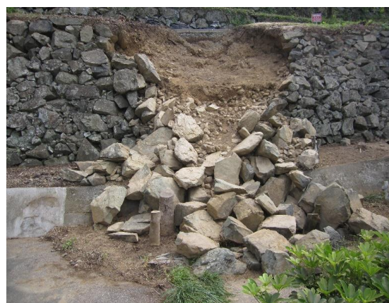
石垣D-1箇所崩落部の様子 (令和5年9月26日)
