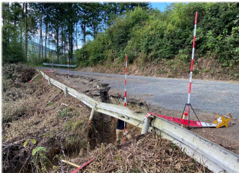
災害により崩れた市道
