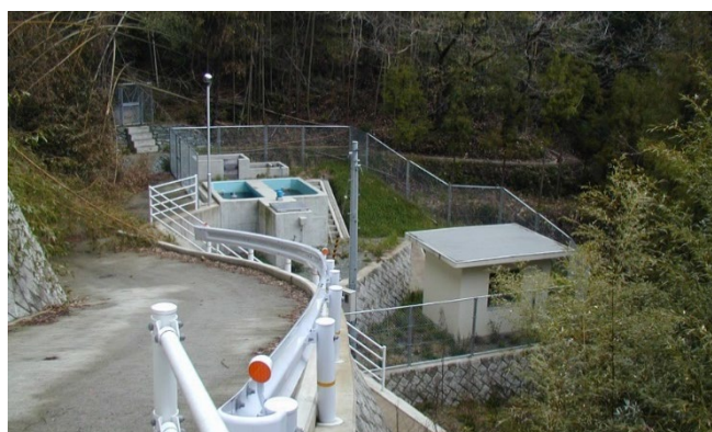
中央旧簡易水道 上中野浄水
