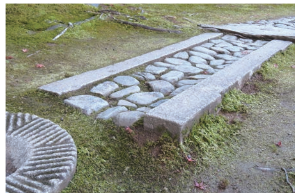
〔写真 4-8〕 延段の不陸
