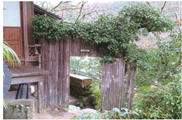
〔写真 4-3〕「路次門」の損傷の状況
