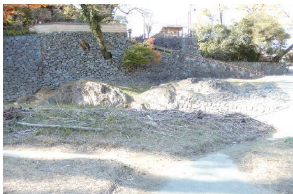
〔写真 4-18〕 護岸の流木竹や土砂堆積の状況
