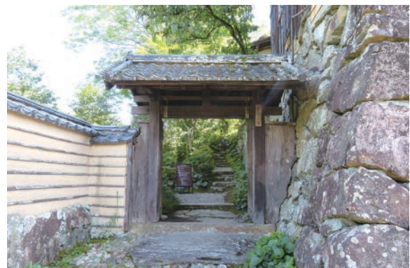
〔写真 4-4〕正門の損傷の状況
