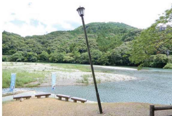
〔写真 4-32〕 照明の傾倒
