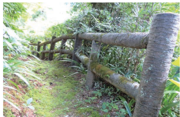
〔写真 4-5〕擬木柵の損傷の状況
