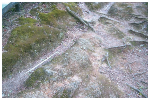
〔写真 4-17〕 表土流出による配管露出の状況
