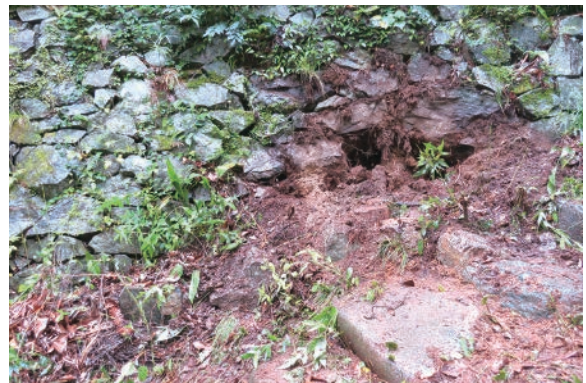
〔写真 4-13〕 石垣の損傷の状況（平成30年撮影）
