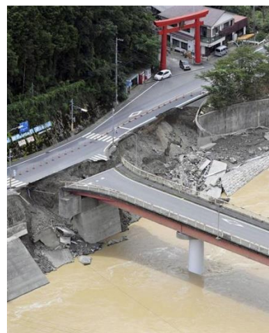
(被災直後の鹿野川大橋付近)
