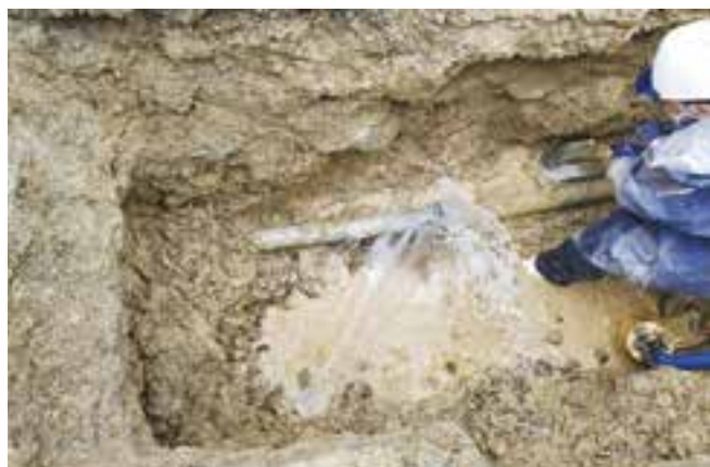
漏水している水道管
