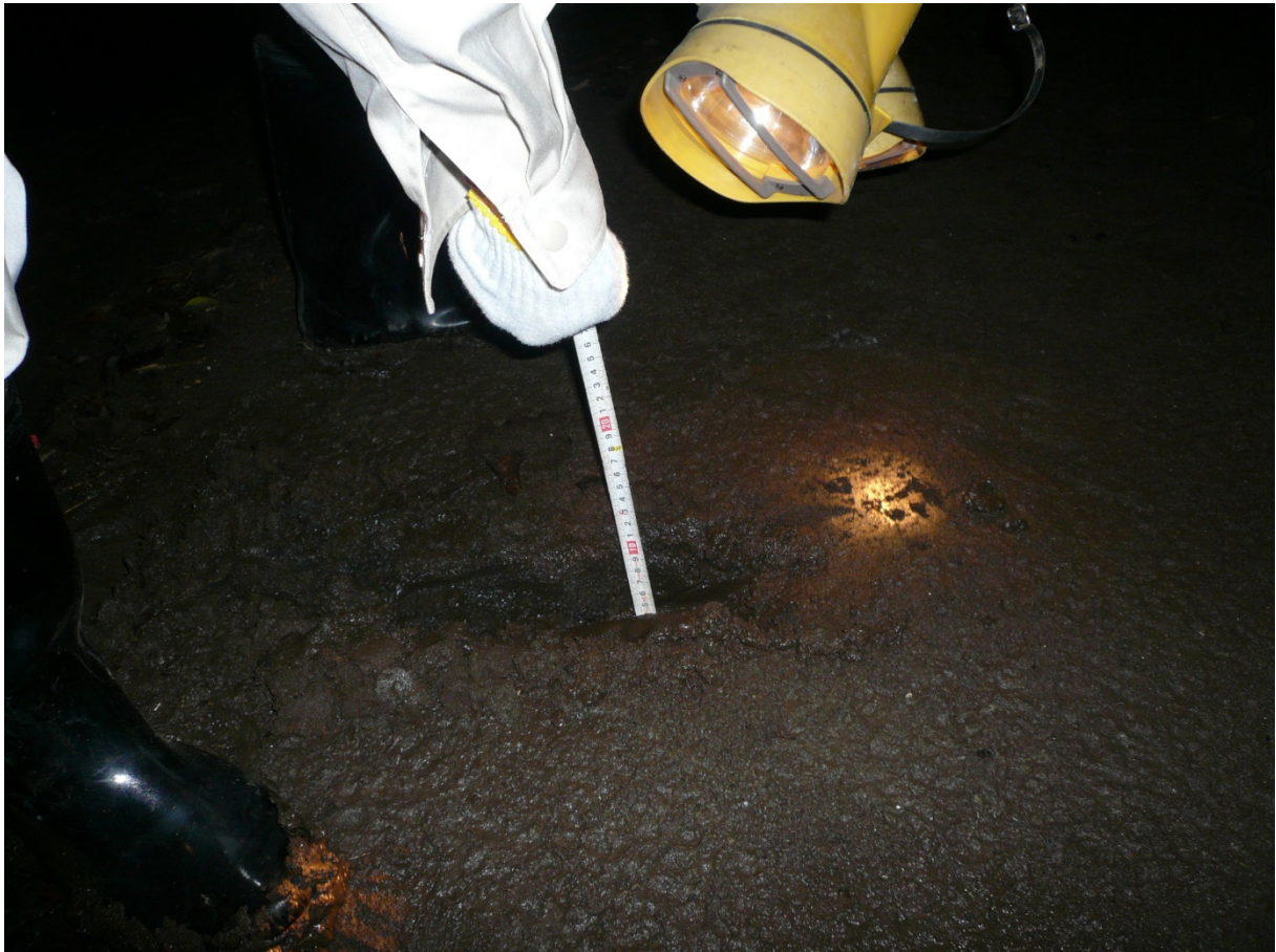
図-26 地下貯留槽に貯まった土砂
