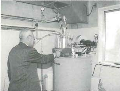
ボイラーに点火する久保田町長
