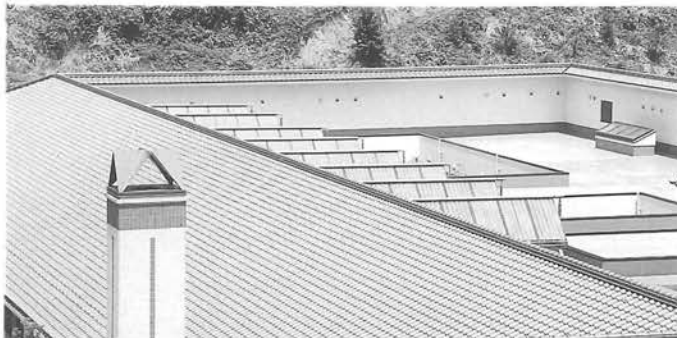
かわかみ荘に設置した太陽熱温水器
