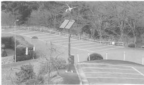
省エネルギー灯設置(鹿野川園地内)
