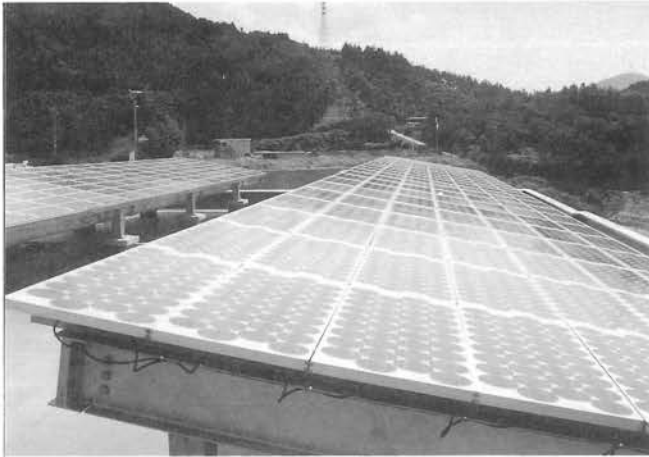
屋上に取り付けられている太陽電池モジュール
