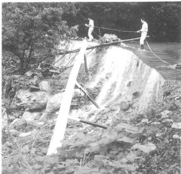
ガードレールが倒れ横断排水が土砂によって埋没 (小倉地区)
