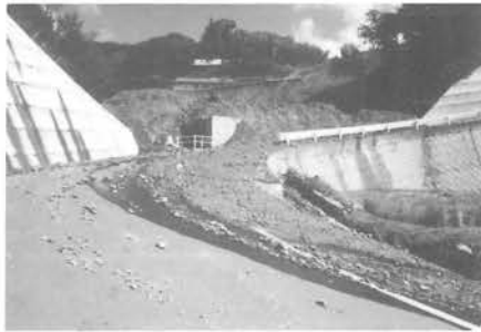
台風19号により崩壊した畑の土砂が道路まで流出(嘉城)
