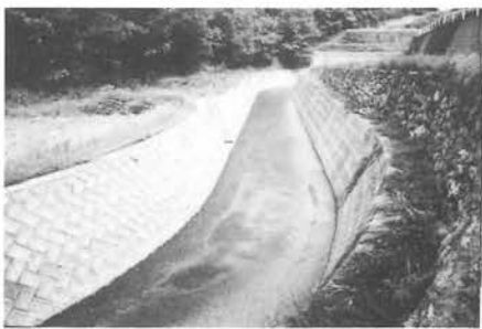
改修され災害の恐れはなくなった反面、魚も住めなくなった(栗田郎川曲田附近)
