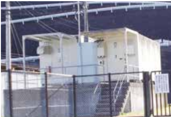
通信ビル（基地局）
