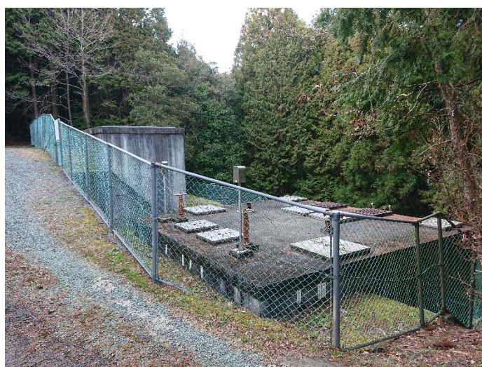
保子野簡易水道 浄水場
