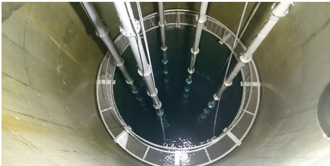
大洲市上水道 五郎水源地 取水井戸
