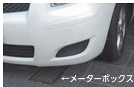
量水器BOXの上に駐車しないでください。
