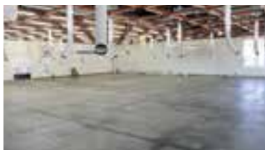
災害発生6日後
