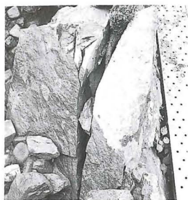
▲大きく割れた石 写真中央やや上に直径約15cmの木根が入り込んでいた
