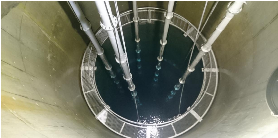
大洲市上水道 五郎水源地 取水井戸
