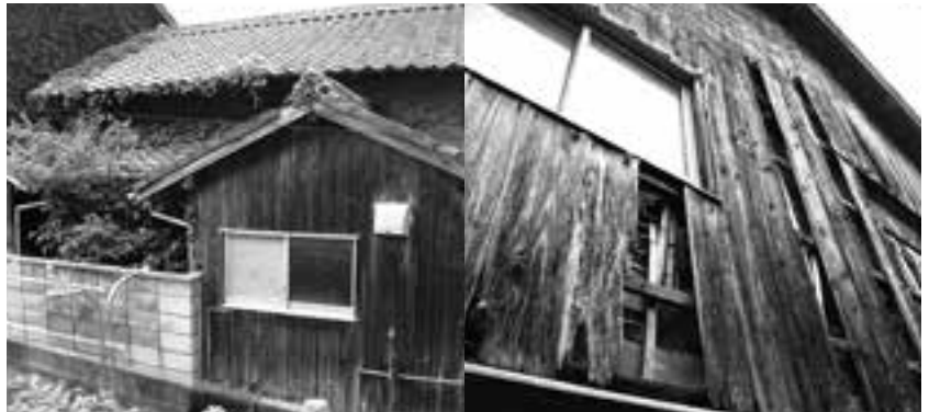
損傷・劣化が進んでいた、取り壊し前の空き家
