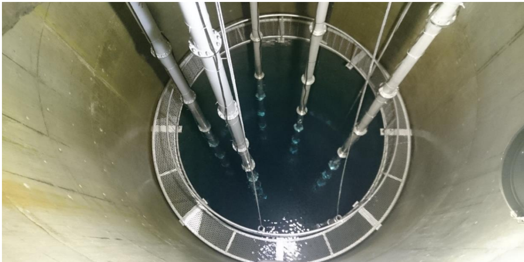
大洲市上水道 五郎水源地 取水井戸
