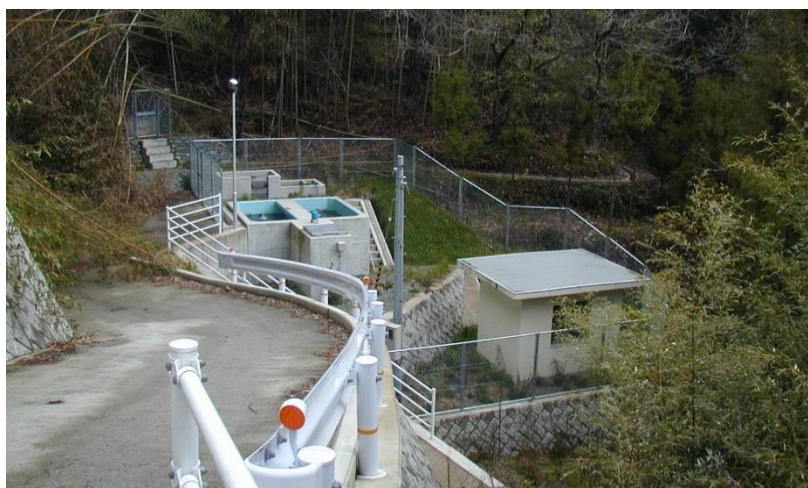
中央簡易水道 上中野浄水場
