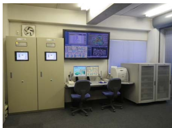
大洲長浜地区中央監視装置
