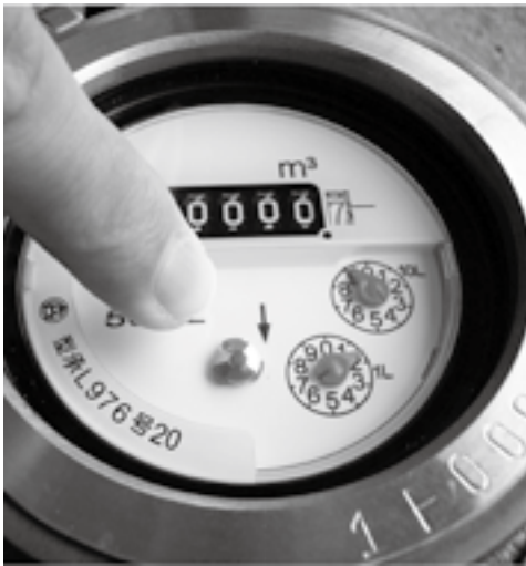
▲水道メーター写真
