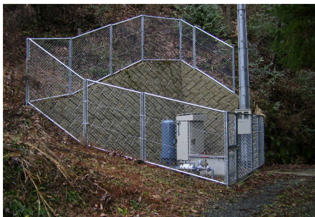
中央簡易水道添谷水源地
