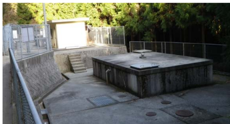
田処簡易水道浄水場
