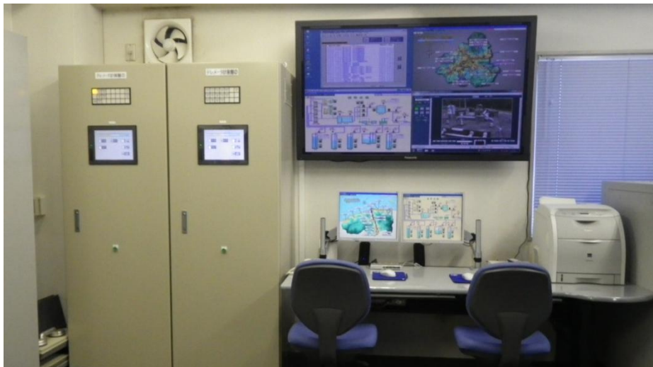
水道管理センター中央監視装置
