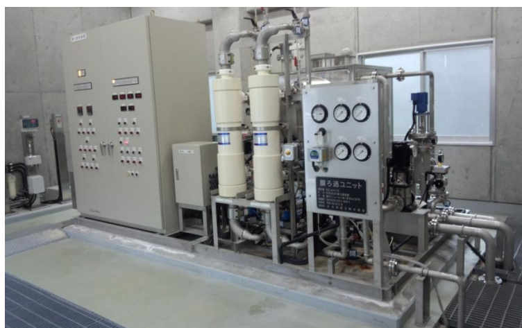
蔵川簡易水道(大洲) 膜ろ過ユニット
