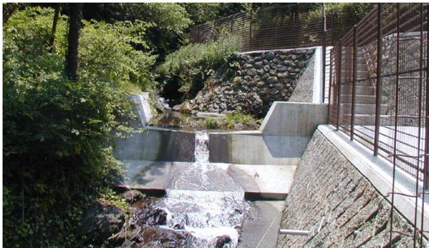
蔵川簡易水道 取水施設
