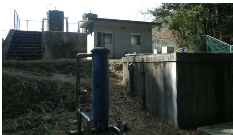
名荷谷簡易水道 汗生浄水
