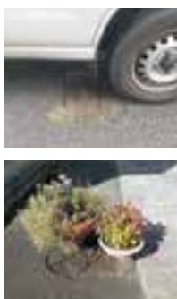
ボックス箇所の悪い例
