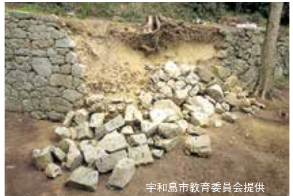
根によって石垣が崩落した例（宇和島城跡）
