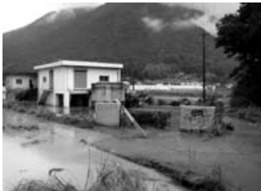
本村水源地の浸水状況(菅田)
