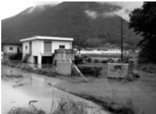
本村水源地の浸水状況(菅田)
