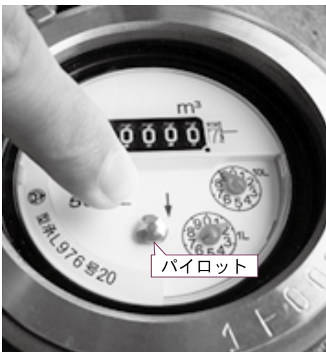
▲水道メーター写真
