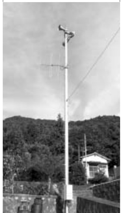
整備が進む防災行政無線施設(白滝)
