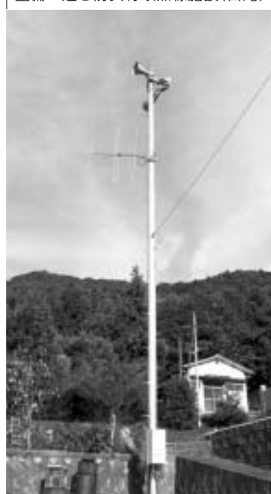
整備が進む防災行政無線施設(白滝)
